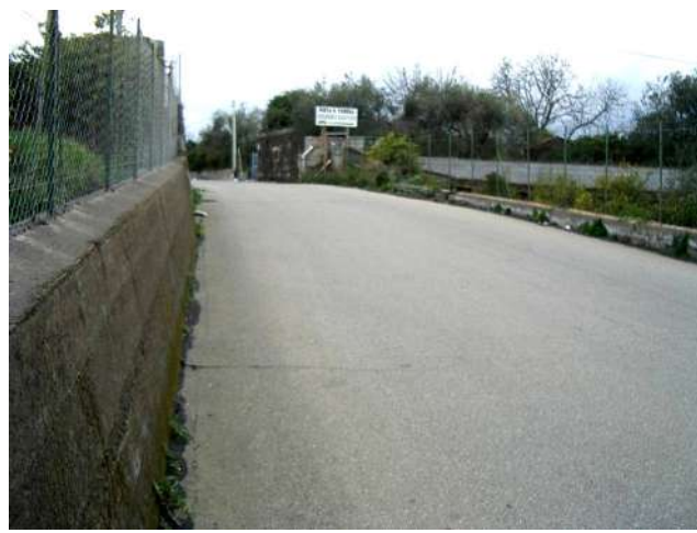
Foto 39 - Zona di fratturazione lungo via Pilieri in vicinanza del kartodromo (immagine del 12/12/2003)
