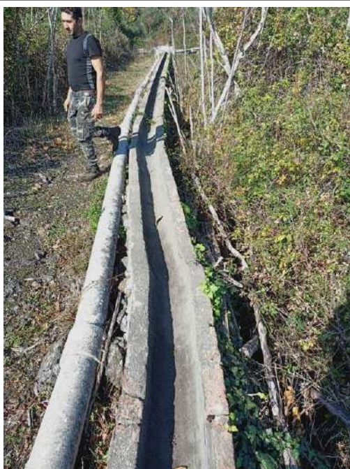
Foto 63 Deformazione canale irrigazione, più volte riparato in via Palombaro
