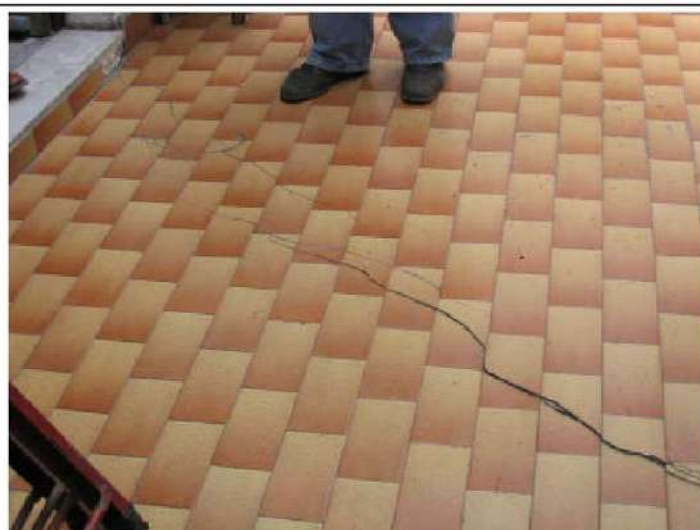
Foto 6 – Frattura sulla pavimentazione di una abitazione sita in via Porto Salvo, dietro l'Ufficio delle Poste (Immagine del 19/07/2005).
