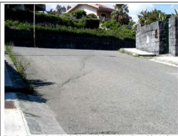
Foto 3 – Frattura lungo la via Maceratoi, in corrispondenza del complesso Mulinia (Immagine del 01/06/2005).
