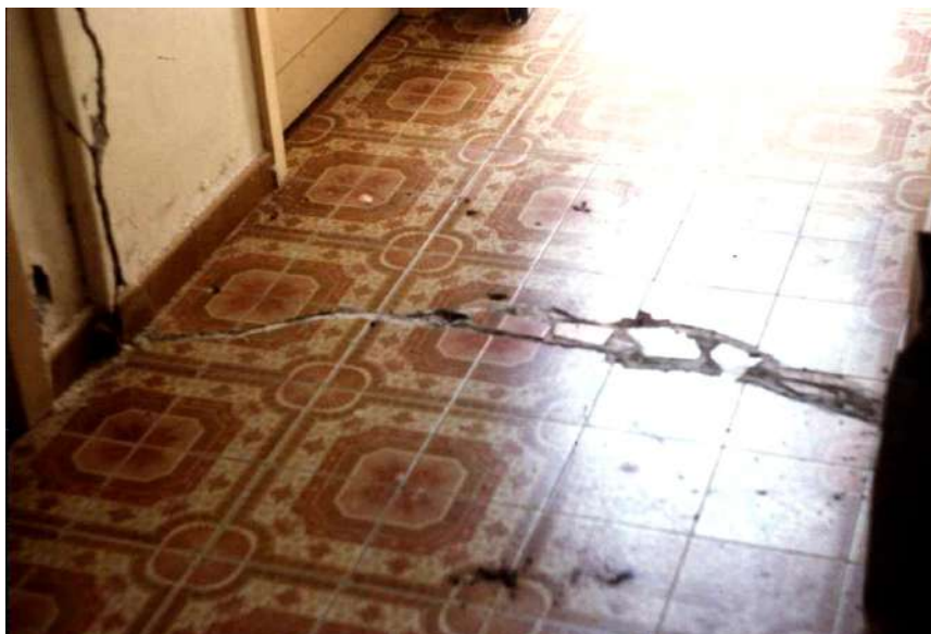
Foto 2: Frattura sulla pavimentazione di un edificio per civile abitazione sito subito ad Est di San Giovanni Bosco (immagine del Maggio 1993).
