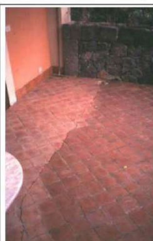
Foto 5 – Particolare di frattura in corrispondenza della pavimentazione di una villetta (Immagine del 15/01/1995 – coll. Dott. Filetti)
