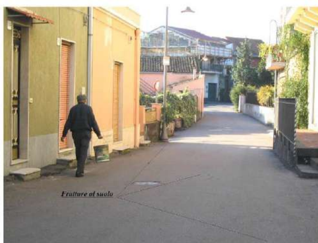
Foto 1: frattura evidenziatasi in via Canale Torto in maniera marcata per "creep asismico" a seguito della crisi sismica dell'Ottobre 2002.
