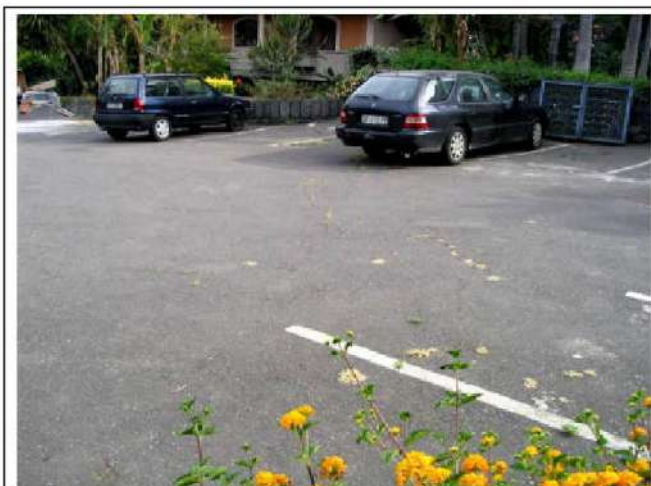
Foto 1 – Deformazioni e fratture in corrispondenza delle strade interne al complesso alberghiero "La Perla Ionica" (Immagine del 20/06/2005)
