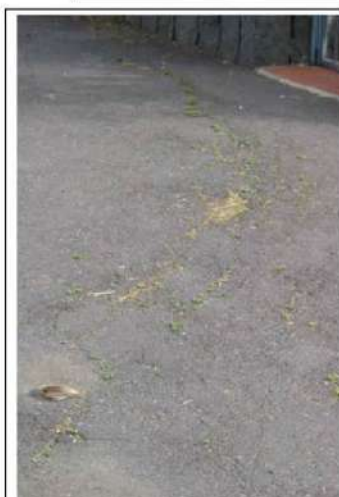
Foto 4 – Particolare zone di frattura lungo la strada interna al complesso Mulinia (Immagine del 01/06/2005).
