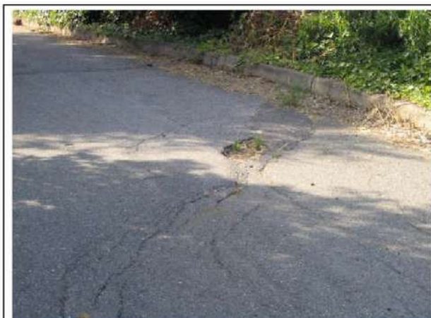
Foto 4 – Zona di fratturazione lungo l'asfalto in una strada che dall'Hotel "Aloha d'oro" conduce verso il mare (Immagine del 20/06/2005).
