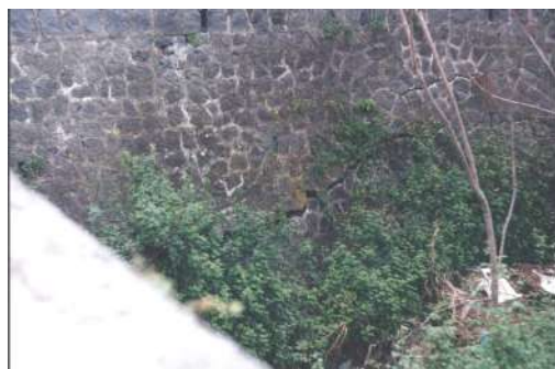
Foto 2: Fratture in corrispondenza del muro perimetrale il T. Pozzillo. Si evidenzia una chiara dislocazione verso Ovest indicante la presenza di una struttura antitetica alla Zona di fratturazione Canale Torto – Malopasso – Grotte (immagine del Maggio 1994)
