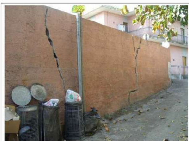
Foto 2 – Zona di frattura in corrispondenza del muro di una stradina (via del mare) posta subito a nord della piazzetta (Immagine del 24/10/2004).
