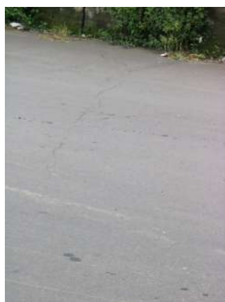
Foto 1: Zona di fratturazione in zona Malpassoti, subito a Nord del limite comunale di Acireale (immagine del Gennaio 2004).
