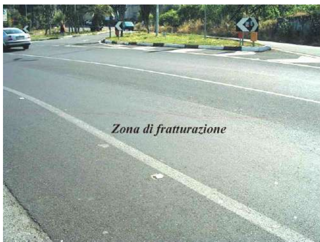
Foto 38 - Fratture lungo la SS 114 in corrispondenza dello svincolo per Santa Maria Ammalati (immagine del 12/12/2003)
