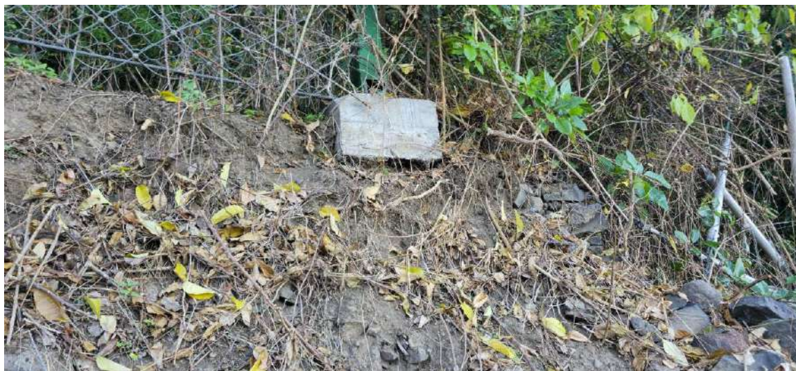
Foto 120– Plinto della rete paramassi a tergo del muro di monte crollato
