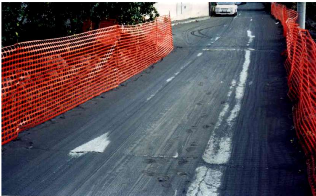
Foto 40 fratturazione in C.da Guzzi in aderenza pozzo SOGIP
