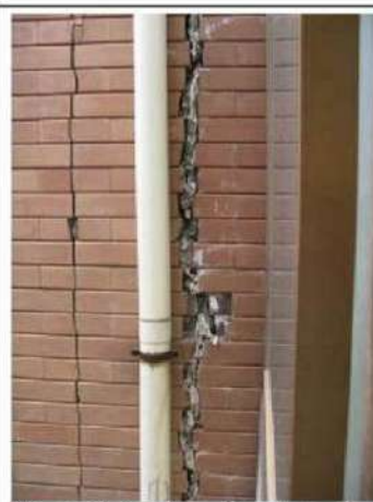
Foto 3 - Fratture in corrispondenza di un giunto tecnico lungo il palazzo delle Terme ottocentesche di Acireale (Immagine del 20/06/2005).
