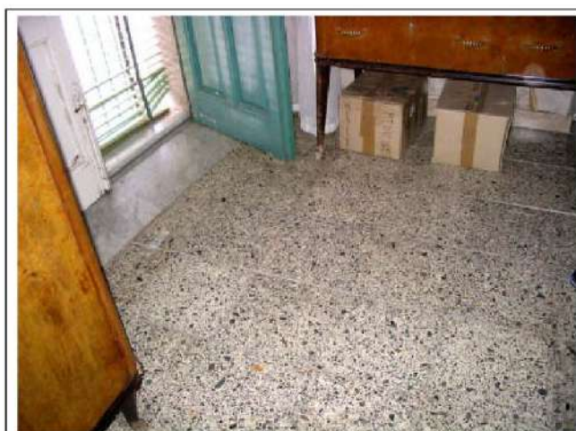
Foto 2 – Fratture sulla pavimentazione della camera da letto della casa precedentemente fotografata (Immagine del 19/07/2005).
