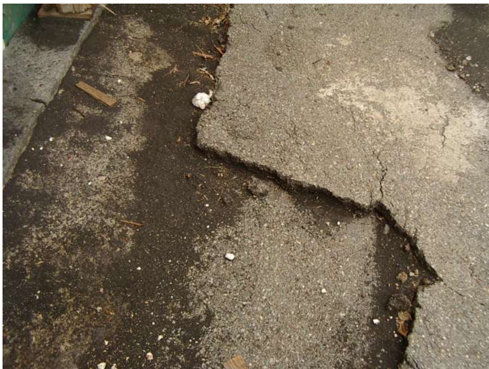
Foto 42 – Fenomeni trans pressive sul manto stradale
