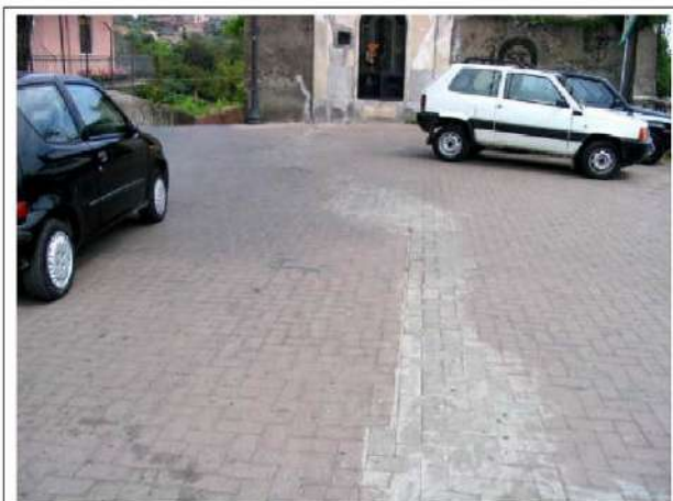
Foto 1 – Zona di frattura in corrispondenza della piazzetta del Belvedere a Santa Caterina (Immagine del 20/06/2005).
