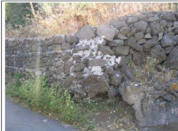
Foto 3 – Colata lavica interessata da una cinematica tensile. La sezione di sbancamento si individua lungo la via Pianetto (Immagine del 20/06/2005).
