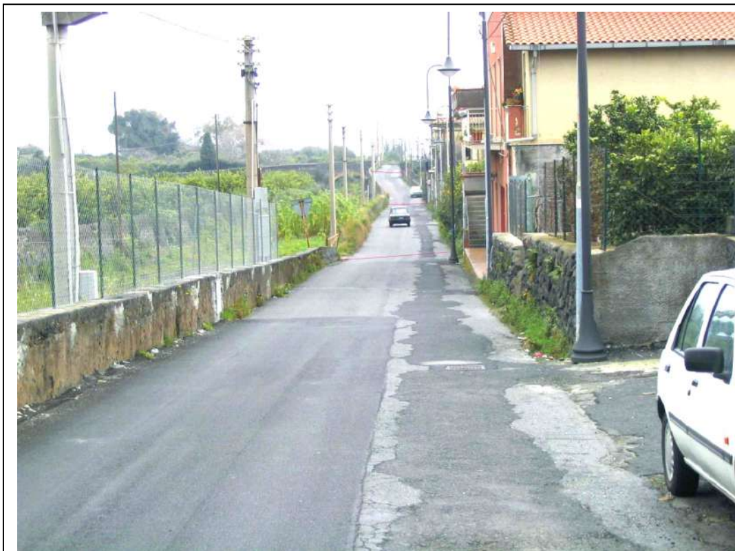
Foto.53 - Fratturazione al suolo lungo il tratto Ovest via Sonnino- le deformazioni trasversali sono da ricondurre alla presenza delle faglie attive per creep asismico denominate Vallone Pozzillo
