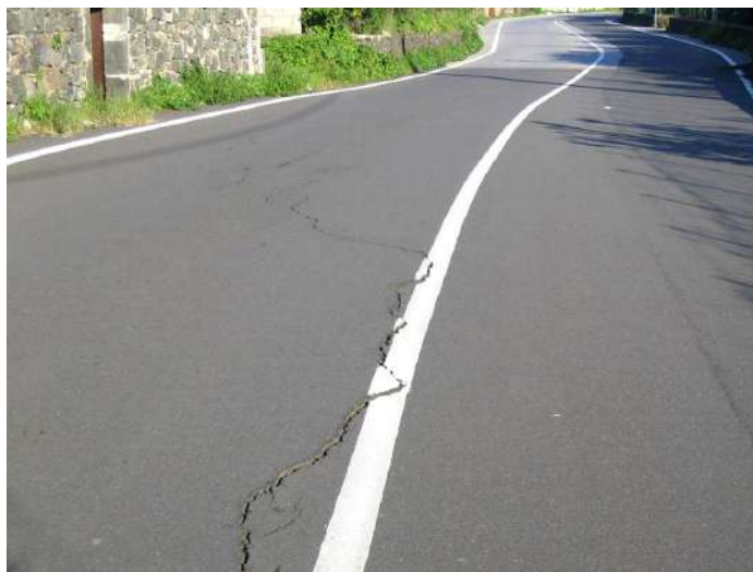
Foto 2: Zona di fratturazione lungo la S.P. per Riposto (immagine del 22/21/2003)
