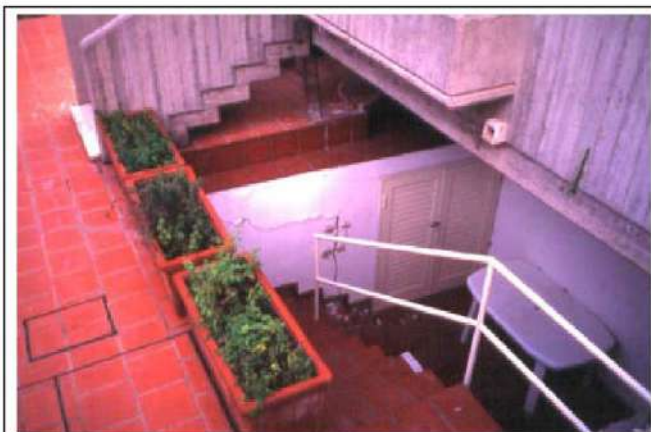
Foto 2 – Aperture lungo opere murarie site in un cantinato di una villetta del Complesso Mulinia (Immagine del 15/01/1995 – coll. Dott. Filetti)
