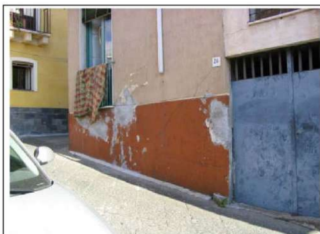
Foto 1 – Danni alle pareti di un edificio sito in via Grasso (Immagine del 20/06/2005).
