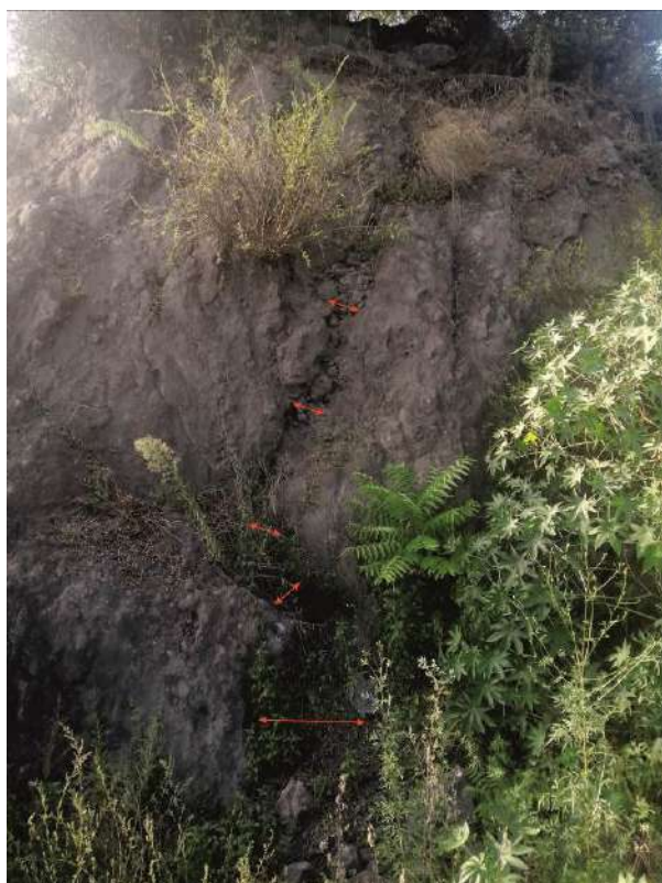
Figura 60 Colata lavica, a tergo del Cimitero di Santa Venerina interessata da fratturazione
