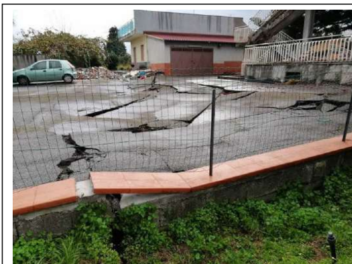
Foto 65 – Frattura sul manto stradale in via Cantagallo
