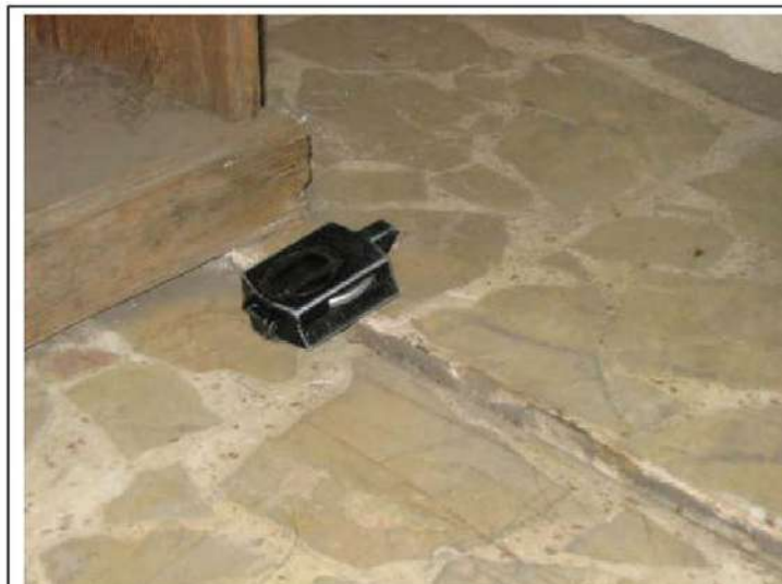
Foto 5 – Frattura sulla pavimentazione di una abitazione avente il prospetto sulla piazza IV Settembre ad Aciplatani (Immagine del 19/07/2005).
