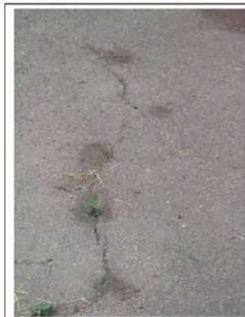
Foto 2 - Fratture in corrispondenza dell'asfalto all'interno del complesso delle Terme ottocentesche di Acireale, al di sopra un campetto di Tennis (Immagine del 20/06/2005).
