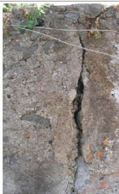
Foto 8 – Frattura lungo il muro di delimitazione di terreni agricoli posti subito a Nord di via Orfanelli (Immagine del 19/07/2005).
