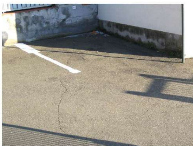
Foto 2: fratture all'interno di un complesso edilizio in via Canale Torto (immagine del Febbraio 2004).
