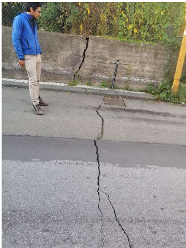
Foto 29 – Frattura sul manto stradale e sul muro in via Don Giuseppe Re.
