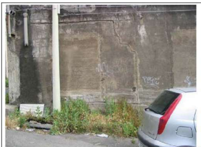
Foto 1 - Particolare di danni ad un edificio posto al di sopra della zona di fratturazione (Immagine del 20/06/2005).
