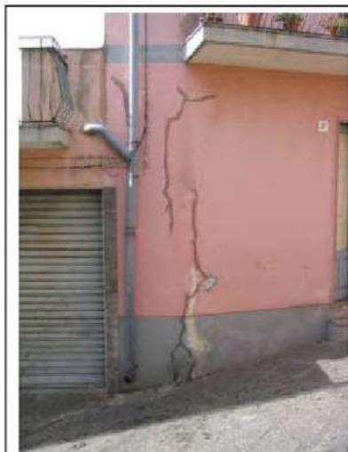
Foto 4 – Edificio a Sud del precedente: si evidenziano delle fratture sul prospetto (Immagine del 19/07/2005).
